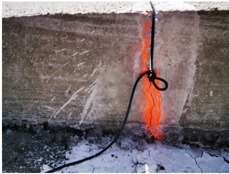
Obr. 8: Kontrakčná rezaná škára a vzniknutá trhlina
